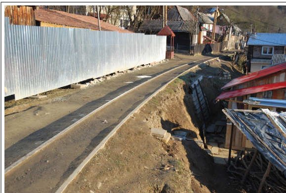
Terasamentul liniei distrus de către autori necunoscuți
